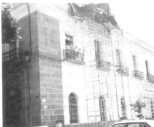
写真5 石組積造住宅の屋根飾りの落下
