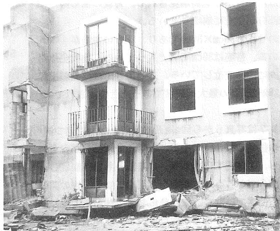
写真6 RC4階集合住宅の1階部分の倒壊
