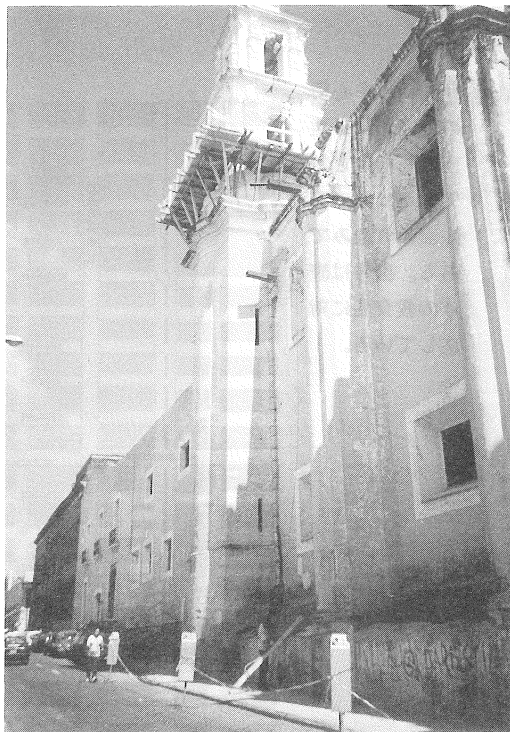
写真1 San Jeronimo 教会鐘塔の被害
