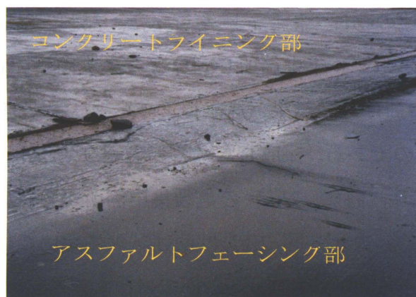
写真-2.14 不同沈下によるアスファルトの亀裂
