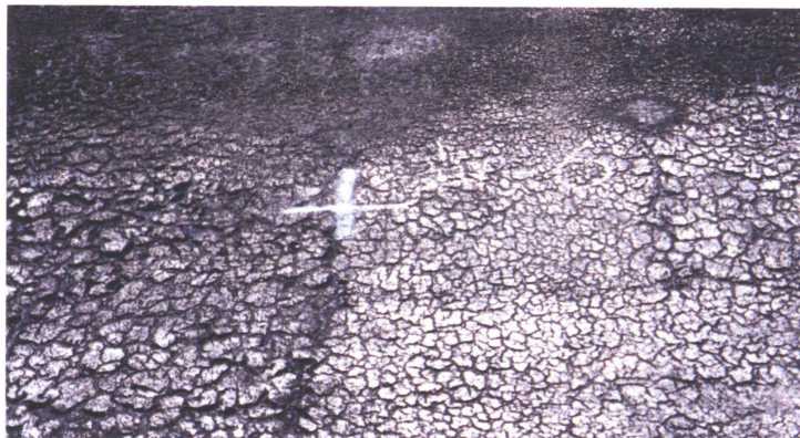
写真-2.7 マッドカーリングに起因する遮水層の荒れ
