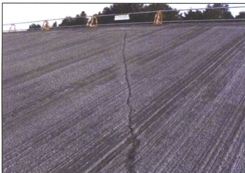
写真-5.1 表層（ストーンシート）切削後の亀裂
