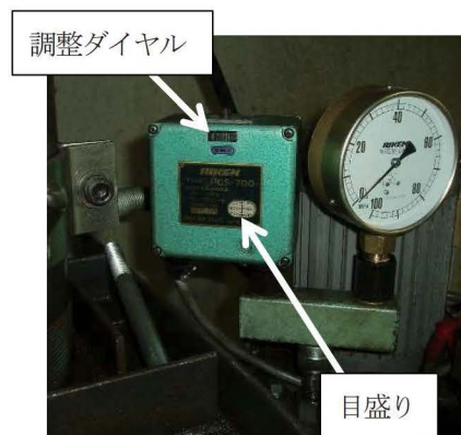
[写真5] 圧力調整スイッチ
