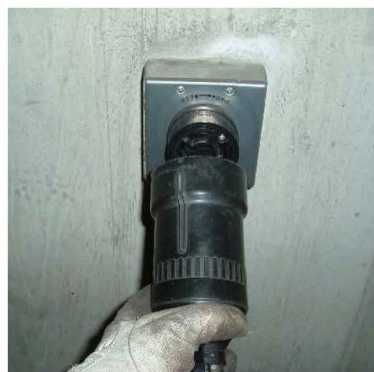
[写真4] 200V電源口
