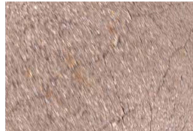
図5 ひび割れ画像サンプル
