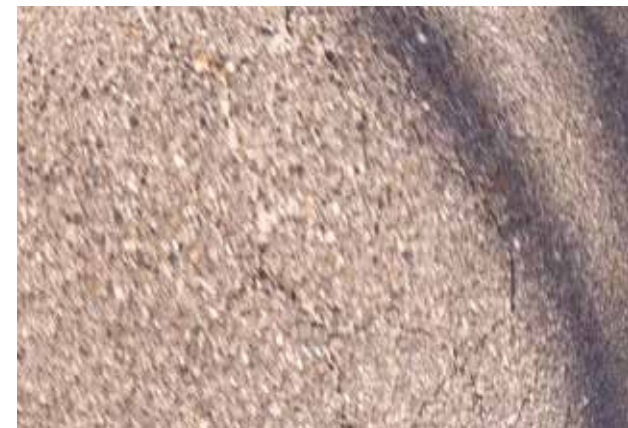
図6 ひび割れ画像サンプル
