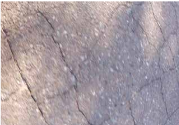
図2 ひび割れ画像サンプル
