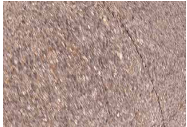
図4 ひび割れ画像サンプル
