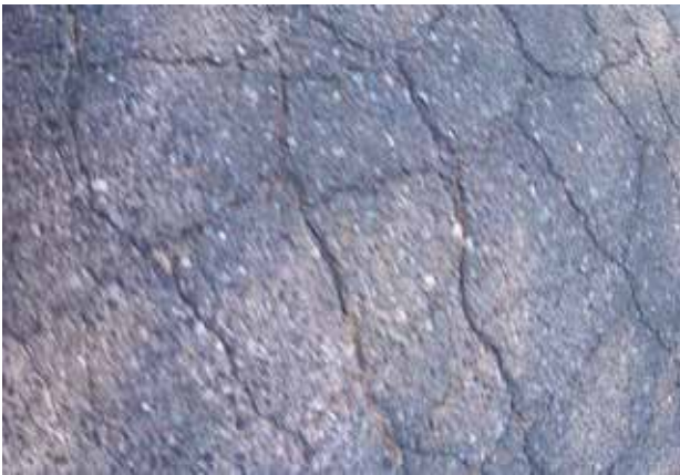
図1 ひび割れ画像サンプル
