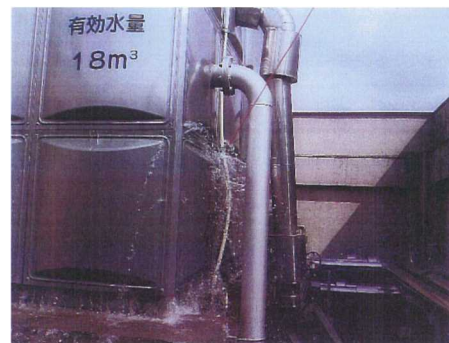
(d) 仙台市，高置水槽，ステンレス鋼製 （設置年不明）
