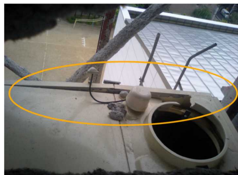
(b) 仙台市，高置水槽，FRP製 （1987年設置）
