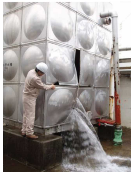
(b) つくば市，受水槽，ステンレス鋼製 （1985 年設置）
