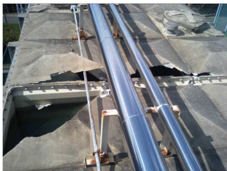
(a) 仙台市，受水槽，FRP製 （1988年設置）
