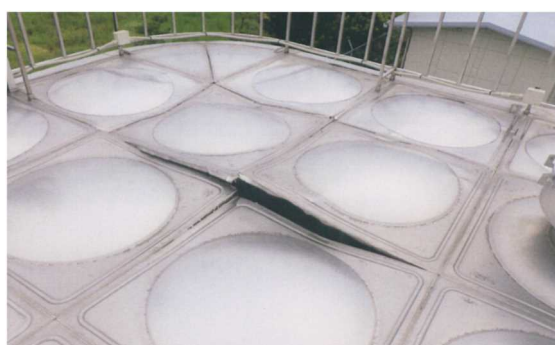
(c) 熊本市，配水池，ステンレス鋼製 (2010 年設置)
