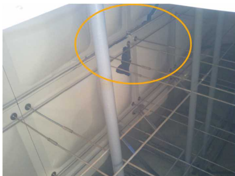
(c) 仙台市，受水槽，FRP 製 （1990 年設置）
