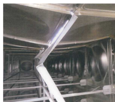
(d) (c)の屋根板直下の内部補強材の破損
