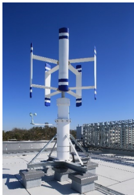
風力発電装置(2kW)
