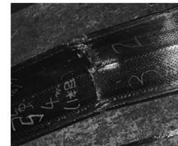
F-1 破壊箇所
