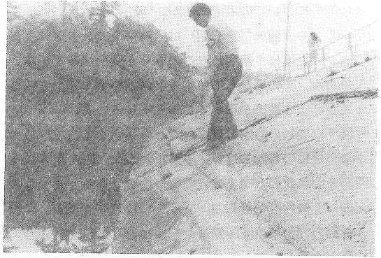
写真4 コンクリートフェーシングの破壊
