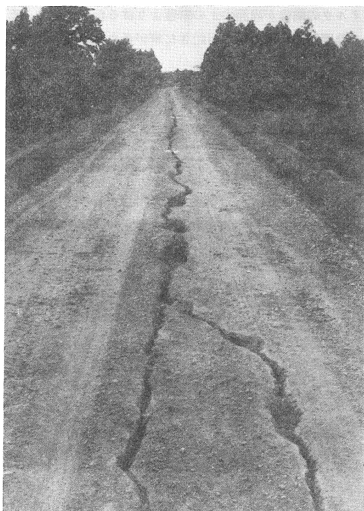
写真15 堤体頂部の縦断クラック (名取川右岸)
