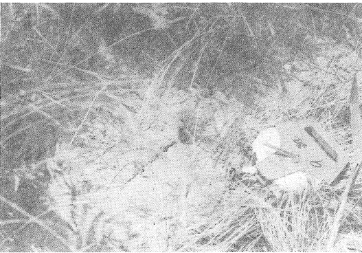
写真3 地山との取付部の亀裂
