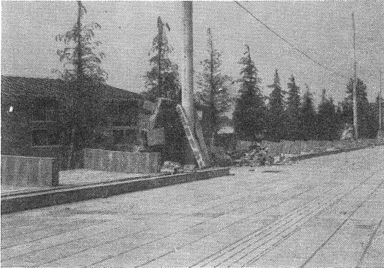
写真28. 鹿野小学校（緑ヶ丘）のブロック塀の倒壊
