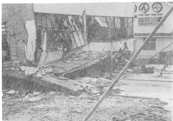
写真15. パロマ営業所の被害 (苦竹)
