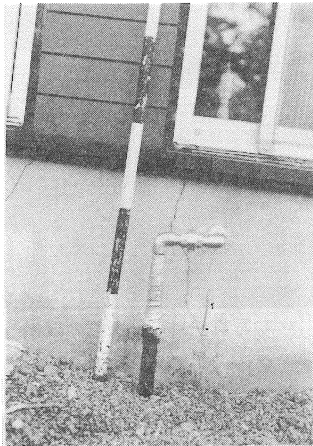
写真-14 地盤の沈下状況
