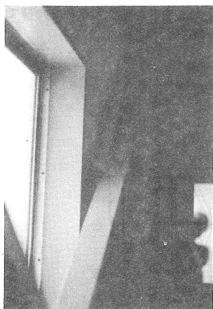
写真-4 2階洗面所前の筋かい座屈
