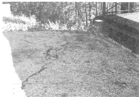
写真-21 玄関前の地割れ
