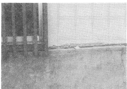
写真-19 北面桁行方向の外壁目地の損傷
