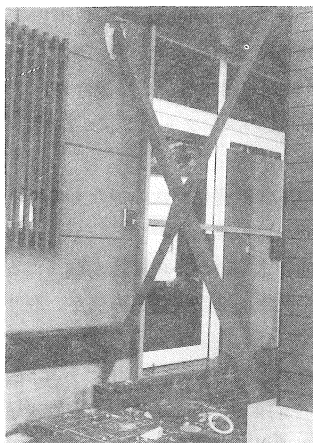
写真-2 玄関前の筋かい座屈
